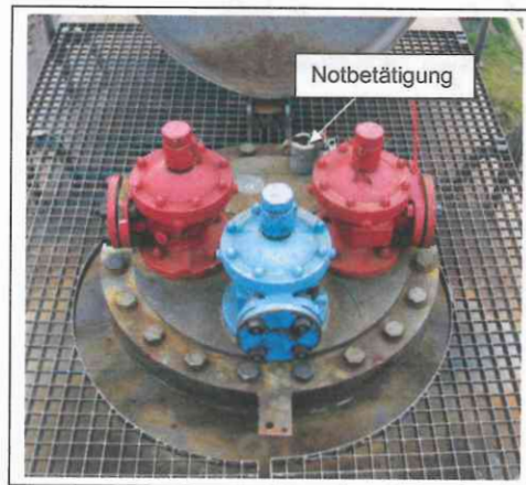
Abb. 50 Chlordom mit Phönix-Armaturen
